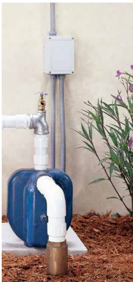
relés de arranque de bomba
